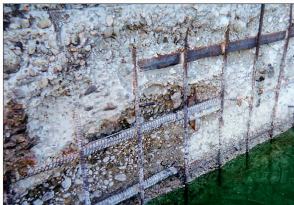
Участок разрушенного бетона в зоне переменного уровня воды
