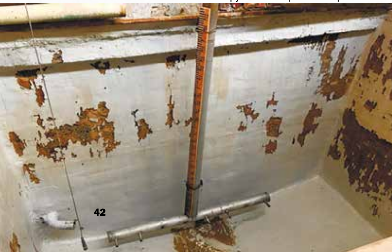
Рис. 1. Разрушение защитного покрытия баков
